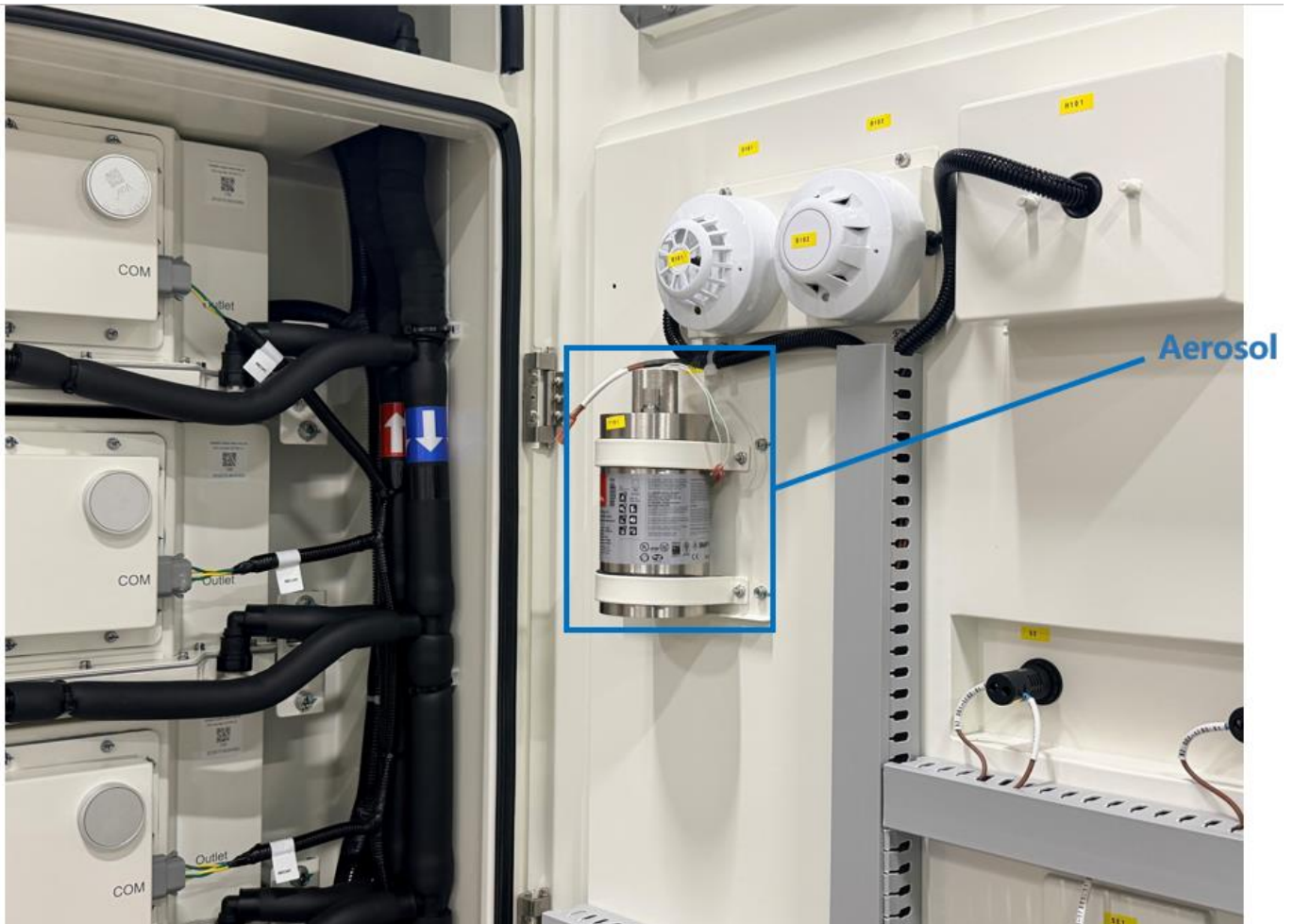
Fig. 10-3 Aerosol Fire Suppression
